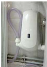
Pompe de relevage
